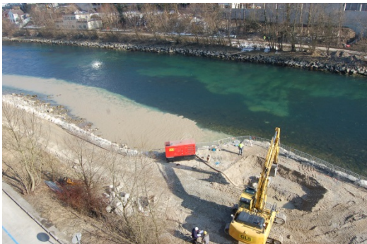
Unzulässiges auspumpen von Grubenwässern, Trübung bis über die Messstelle am Ortskai hinweg
